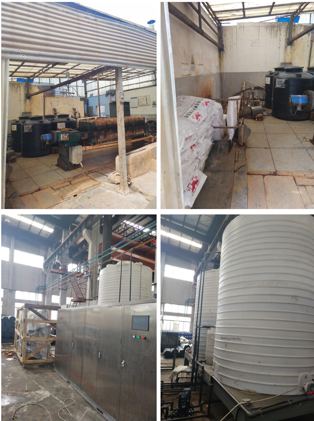
图 3.12 污水处理站情况
