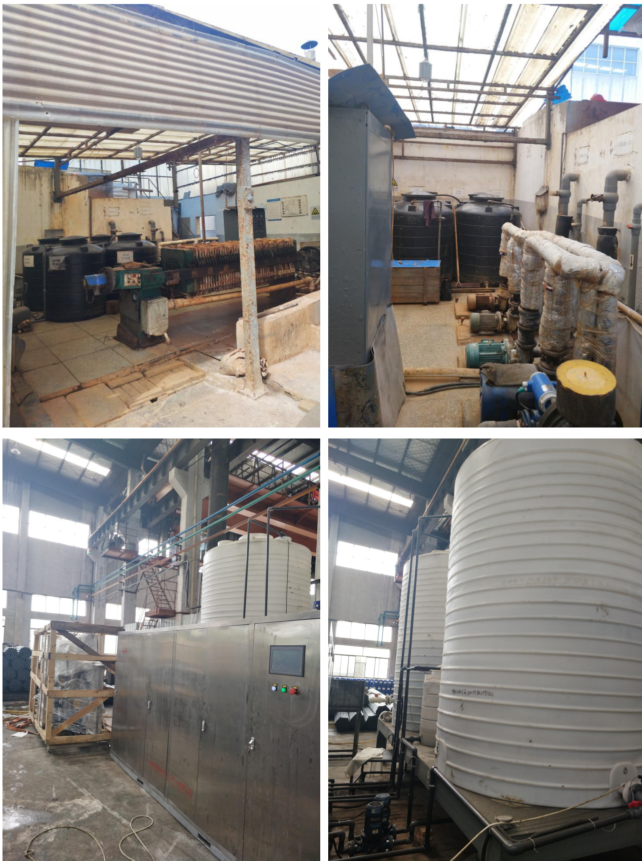
图 3.6 管道运行情况
