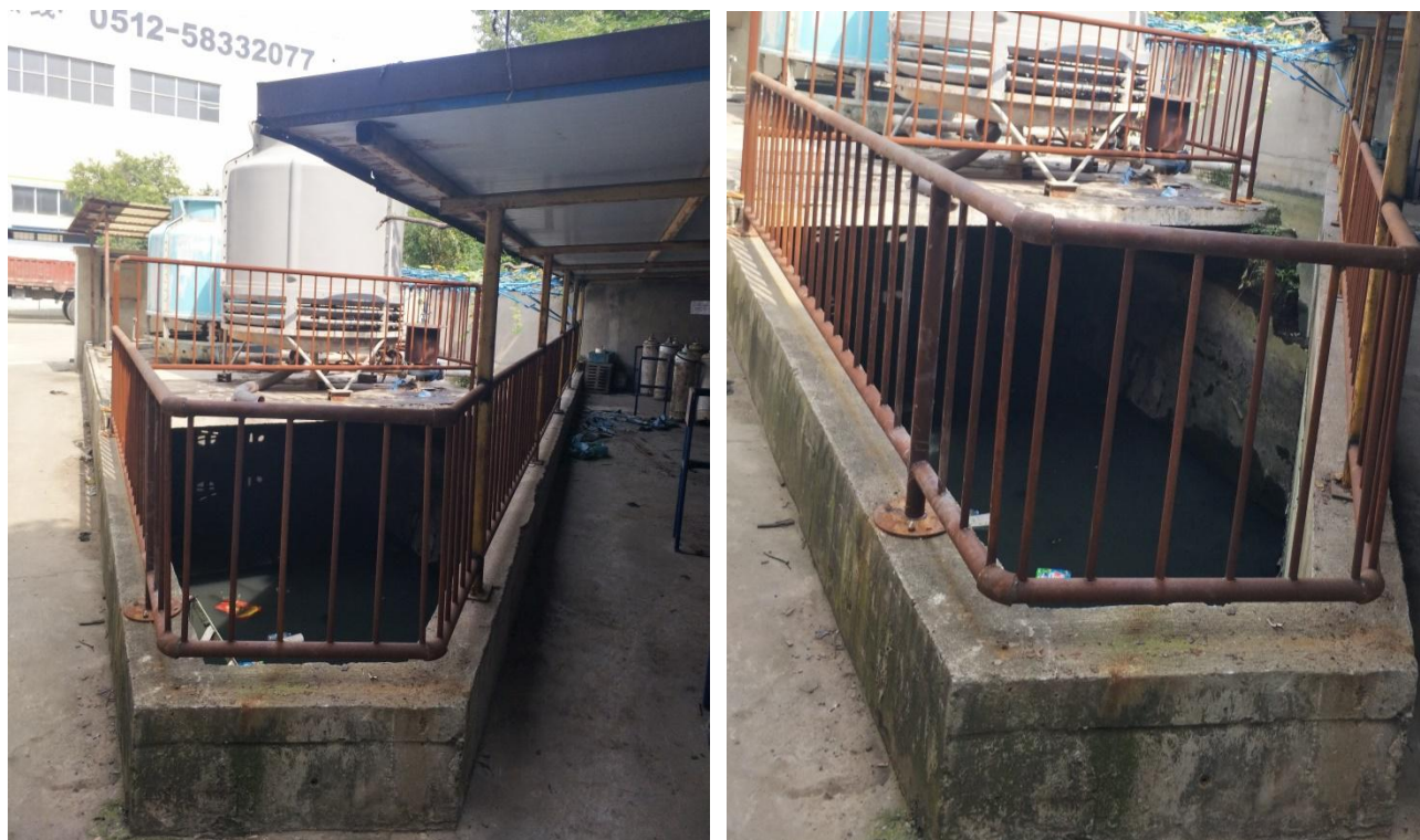
图 3.4 水坑和收集池
