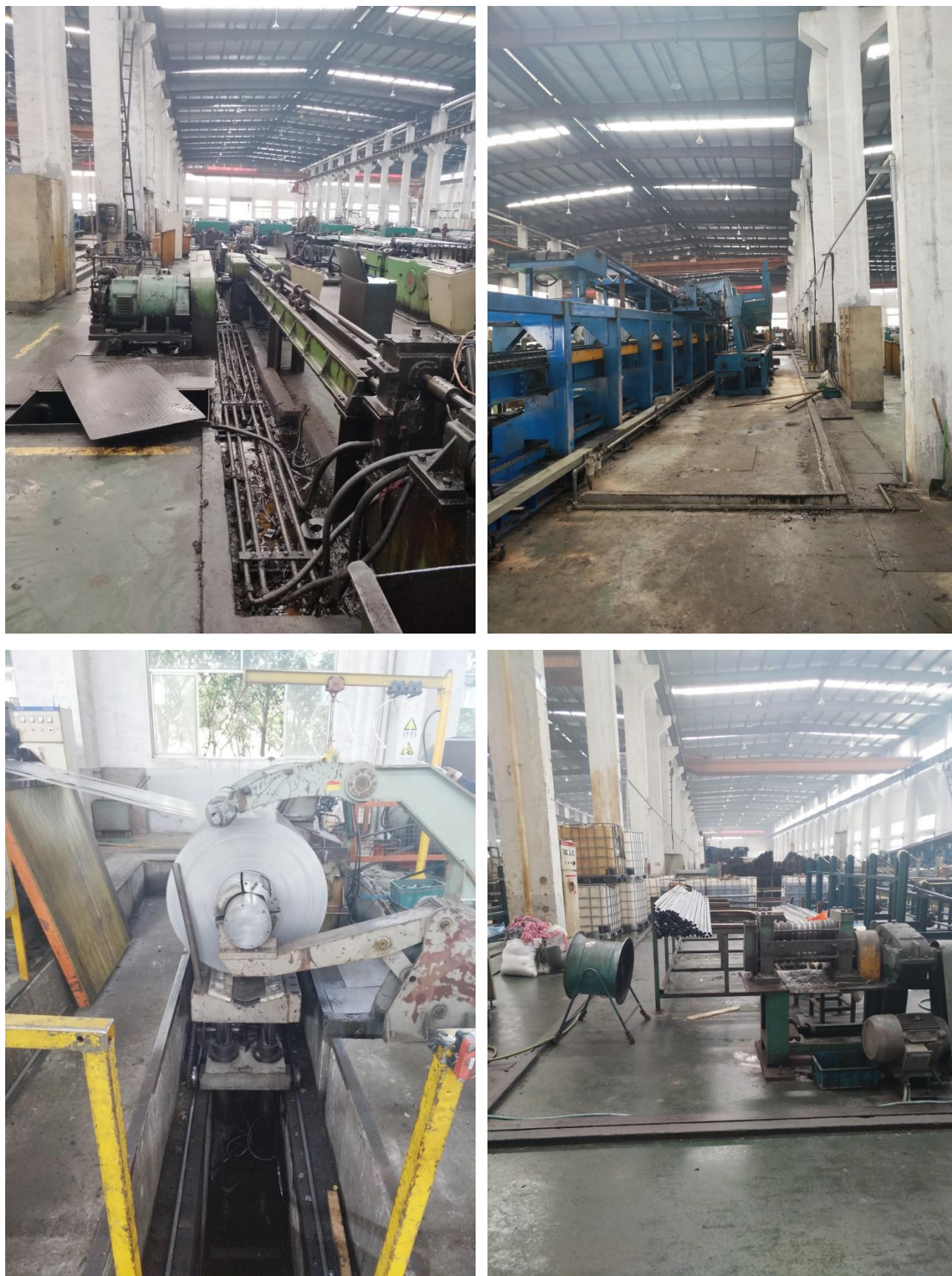
图 3.11 生产加工装置及地面防渗情况
