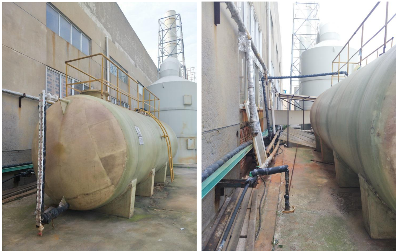
图 3.3 离地的悬挂储罐及地面防护情况
